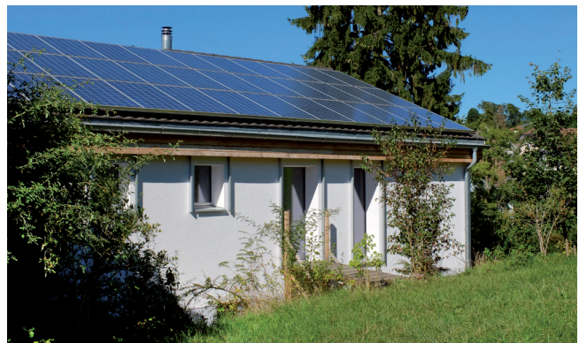
Eigener Strom im renovierten Minergie-P-Gebäude dank einer Photovoltaikanlage von 65 m 2 Fläche.
