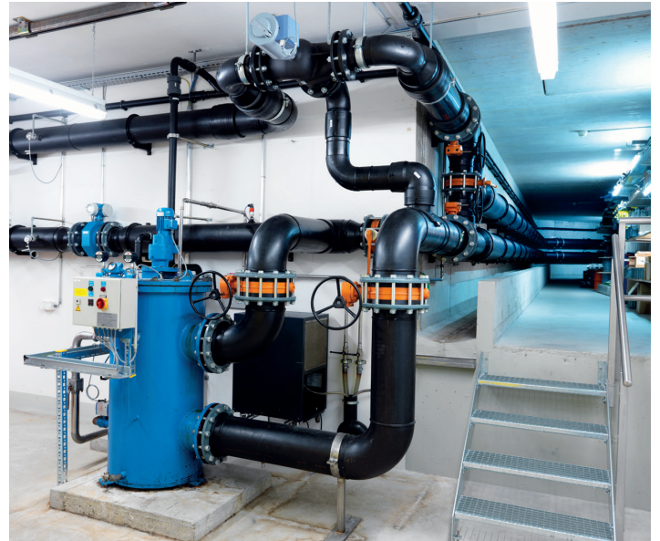
Nutzungsstation mit Filteranlage des Seewasser Konsortiums
